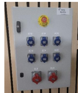
Armoire au mur où nous pouvons brancher directement du 32A en P17 ou plusieurs 16A
